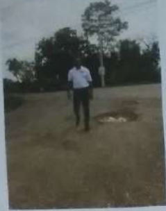
INICIO DE LA RECONSTRUCCIÓN DE LA CARRETERA EL BOMBÓN, DABAÑO Y PLATANAL.
